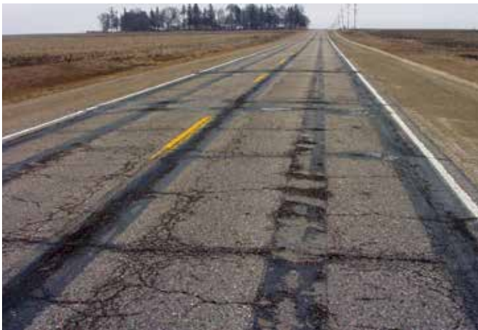
Figura 34. Pavimento asfáltico en estado entre pobre y deteriorado que será reforzado con una capa (fuente: Todd Hanson, Iowa DOT)
