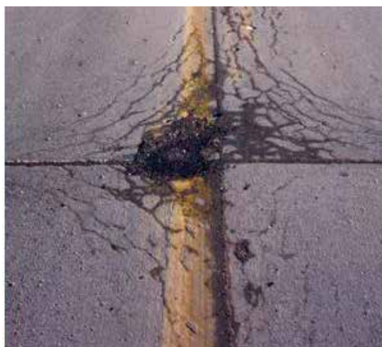
Figura 11. Pavimento con deterioro tipo D
