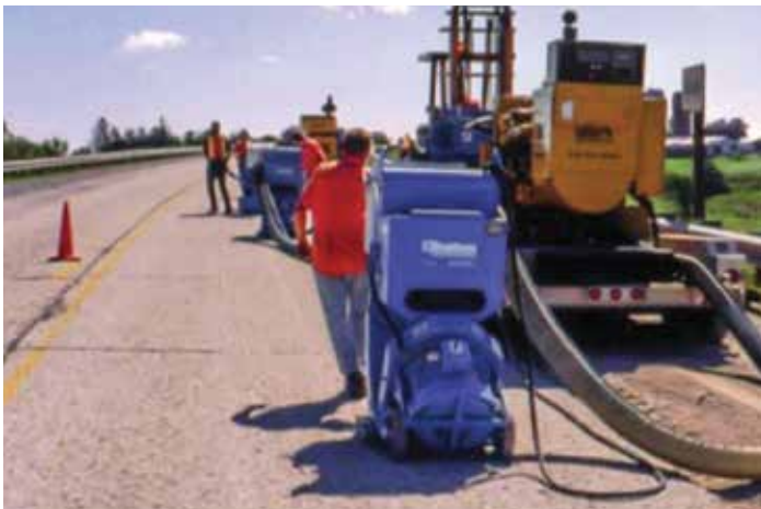
Figura 28. Fotografía de pavimento de hormigón cuya superficie fue previamente tratada con arenado a presión en 1994 (fuente: Todd Hanson, Iowa DOT)
