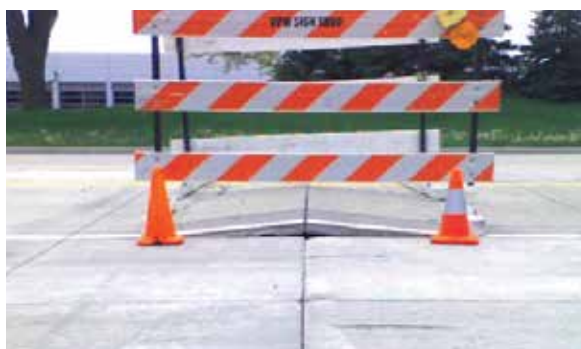
Figura 52. Reventón en una capa de refuerzo donde debió cortarse una junta de expansión sobre la junta de expansión del pavimento de hormigón existente (fuente: Dan DeGraaf, Michigan Concrete Paving Association)
