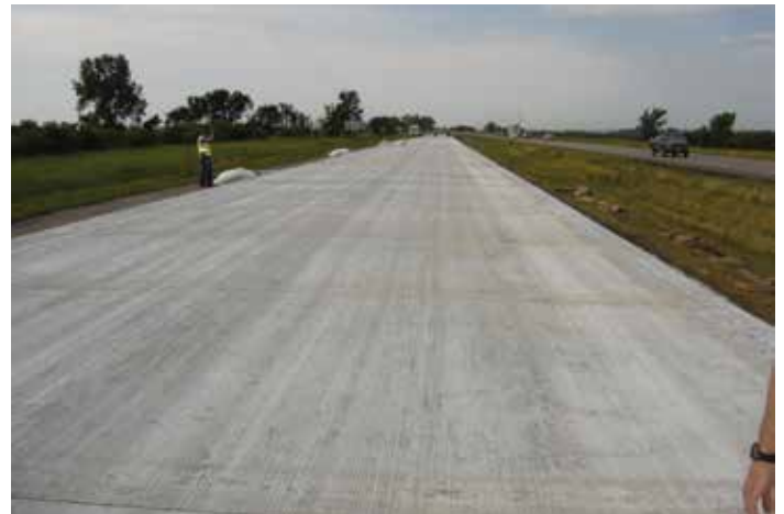
Figura 40. Capa de refuerzo de hormigón no adherida de un pavimento compuesto (fuente: Todd Hanson, Iowa DOT)
