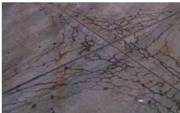
Figura 10. Agrietamiento ASR moderado en el perímetro de las losas (fuente: Thomas et al. 2011)
