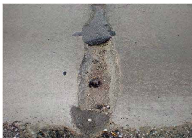
Figura 12. Junta deteriorada típica, parchada con HMA (fuente: Trinity Construction Management Services, Inc.)
