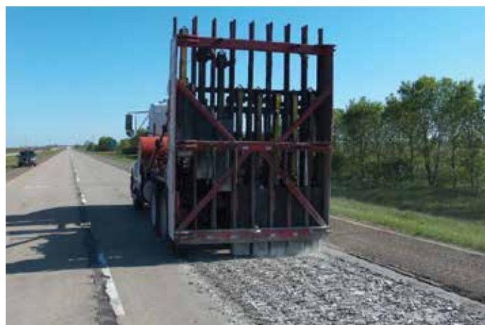
Figura 122. Pavimento de hormigón desintegrado (fuente: Todd Hanson, Iowa DOT)
