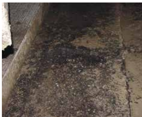
Figura 53. Desprendimiento del asfalto de una capa separadora (fuente: Dan DeGraaf, Michigan Concrete Paving Association)
