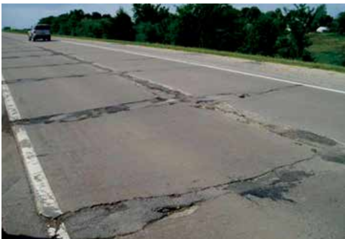
Figura 44. Ruta D35; pavimento existente en malas condiciones (fuente: Todd La Torella, MO/KS Chapter, ACPA)
